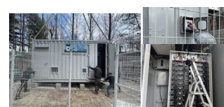
250kW/300kWh 규모 ESS 실증 사이트
